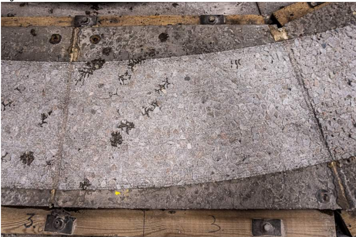
Figur 9 5H-2L (fläckar är kondensdropp från taket)
