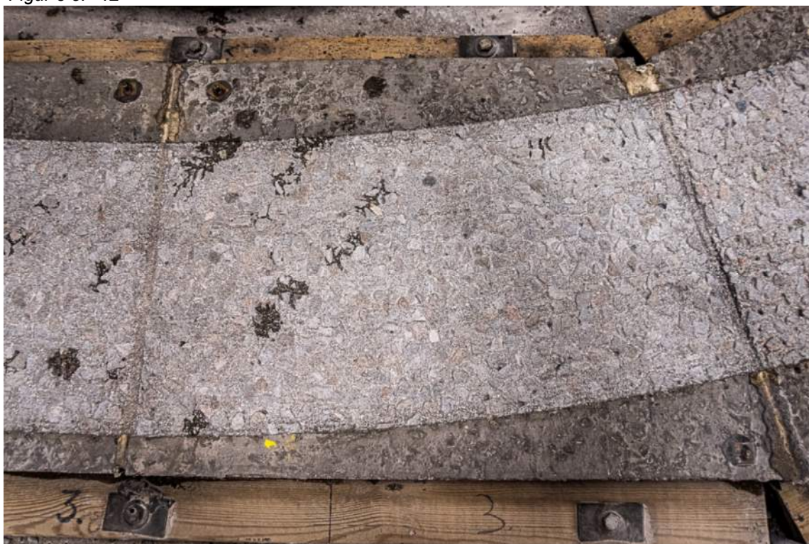
Figur 9 5H-2L (fläckar är kondensdropp från taket)
